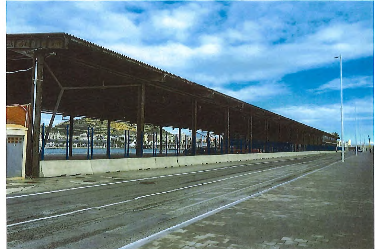
Figura 32. Vista general desde el Sur del tinglado que ocupa el tercio noreste del muelle 14.
